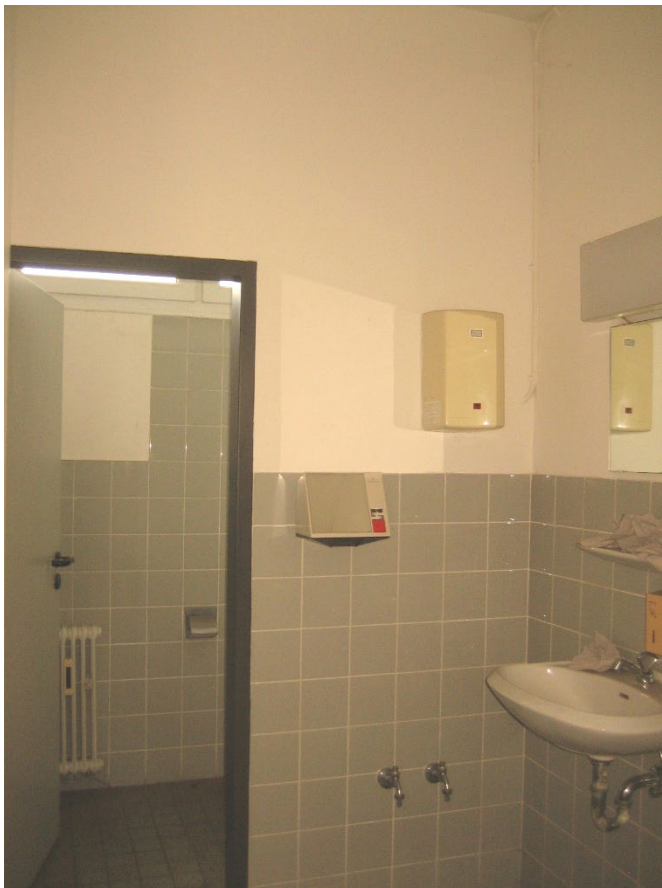
typischer Sanitärbereich im EG bis 3. OG
