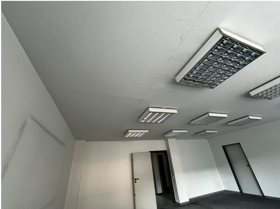
Installationen an abgehängter Decke
