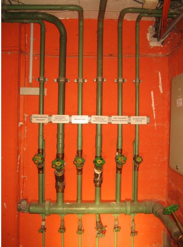
Trinkwasserverteiler im Keller
